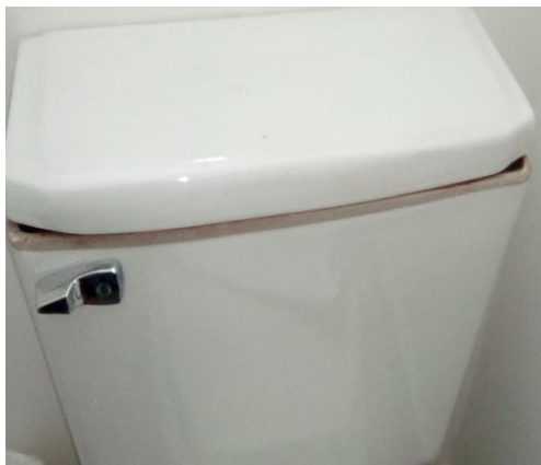
Tapa de inodoro dañada
