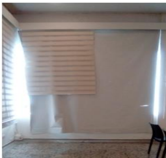
Blackout mal estado Salón convenciones
