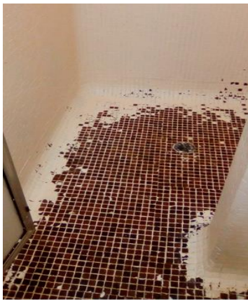
Pozo de agua en la ducha
