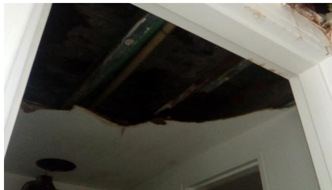
Techo caído en la habitación 335
