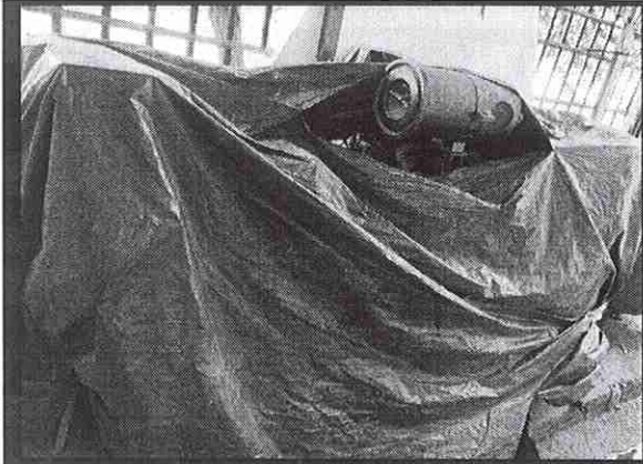
Foto 20 planta eléctrica (antigua)
