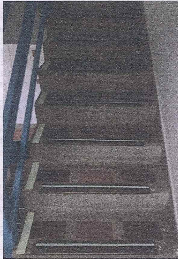
Cinta reflectora en escaleras
