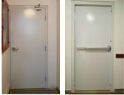
Puertas salidas de emergencia
