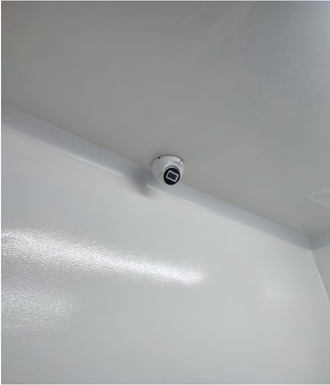
Cámara Zona de Lavado.
