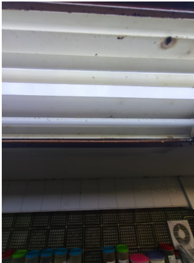
Imagen 11. Lámpara de cocina sin protección y presencia de insectos.
