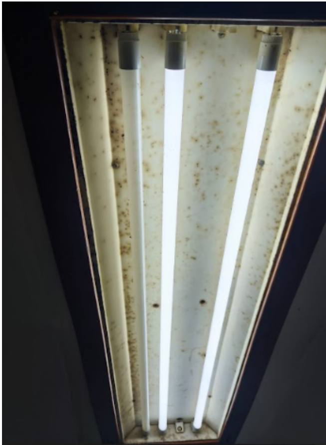
Imagen 13. Lámpara de cocina sin protección con foco sin funcionamiento.
