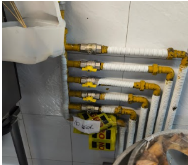
Imagen 36. Paso del gas con aviso de "No Tocar"
