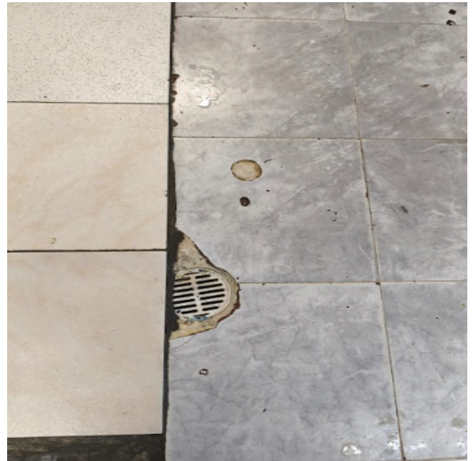
Imagen 6. Piso de cocina con baldosa rota y baldosas beige con porosidad.
