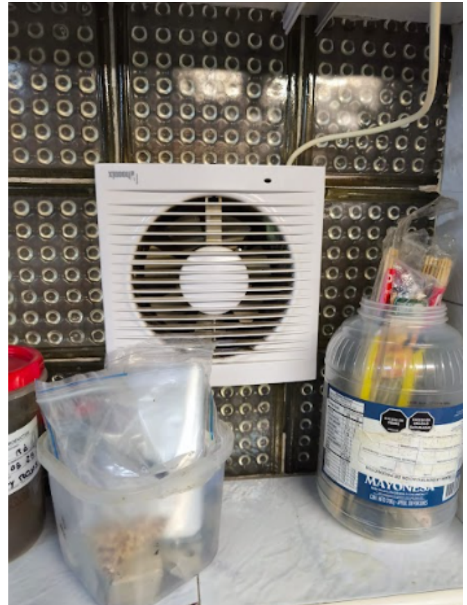
Imagen 15. Extractor de cocina derecho sin funcionamiento.
