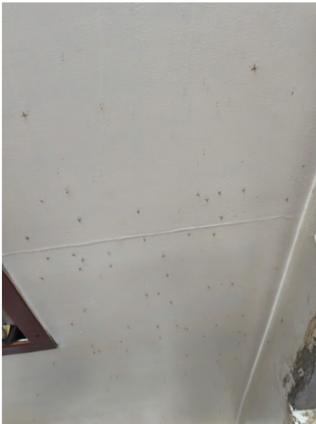
Imagen 10. Doble techo de pasillo para transporte de alimentos con presencia de insectos.
