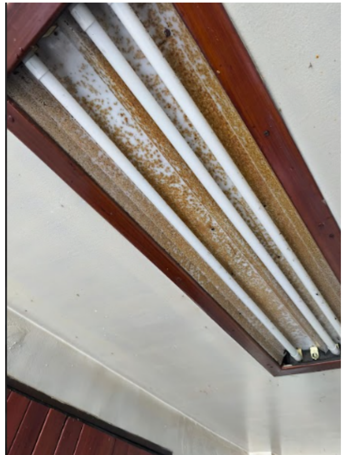
Imagen 12. Lámpara de pasillo sin protección.
