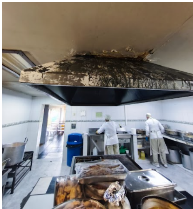
Imagen 28. Campana de extracción con presencia de grasa.
