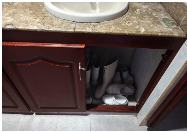
Imagen 30. Gaveta de lavamanos sin puerta.
