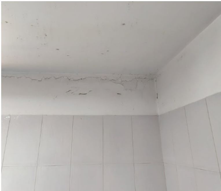
Imagen 7. Pared agrietada y sin sellamiento para impedir la acumulación de suciedad.
