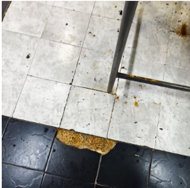
Imagen 5. Piso de cocina con baldosa rota.
