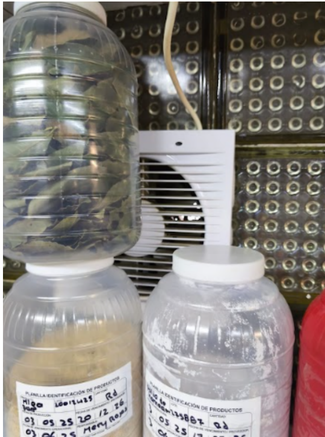
Imagen 14. Extractor de cocina izquierdo sin funcionamiento.
