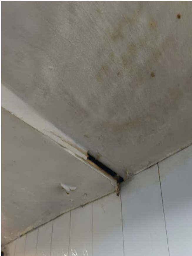
Imagen 8. Doble techo de cocina con desprendimiento.
