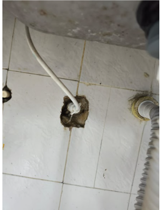
Imagen 22. Desagüe de lavaplatos.
