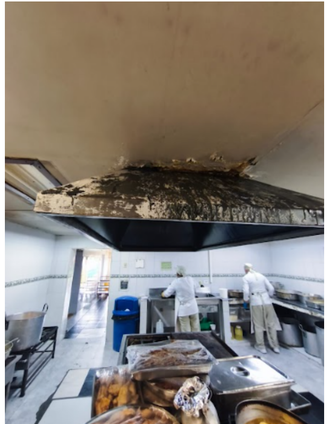
Imagen 9. Doble techo de cocina con signos de agrietamiento.
